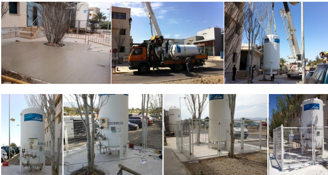
Figura 8. Actuaciones de cimentación, vallado y colocación de tanque de CO 2 líquido y equipamiento para la generación de pellets.
